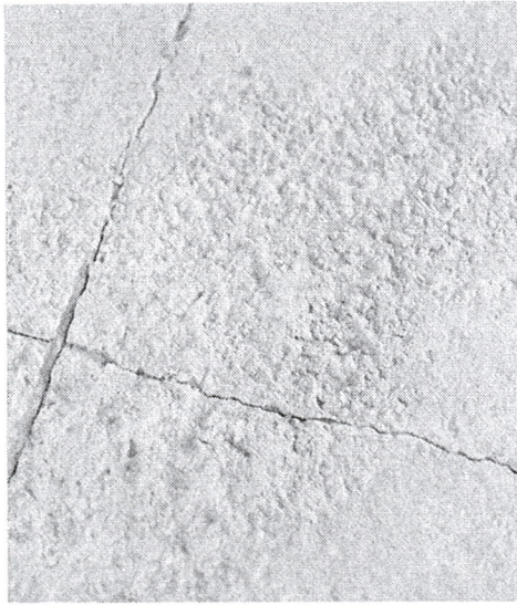
foto 02 - buracos no piso
